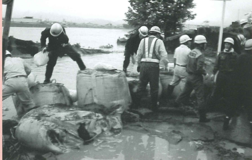
春日1丁目の堤防決壊現場
