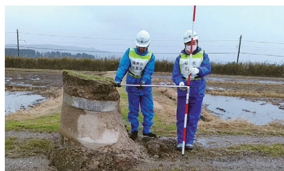
令和6年能登半島地震で浮上したマンホール
