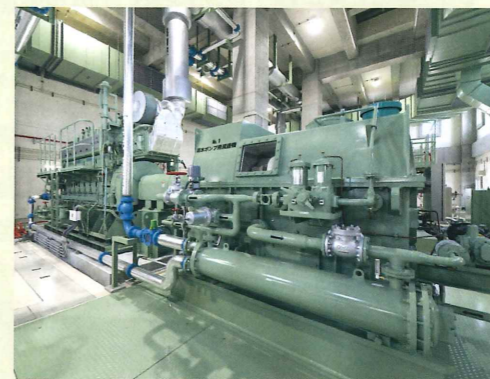
雨水ポンプを動かすエンジン
