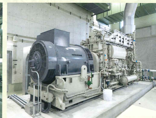
非常用発電設備
