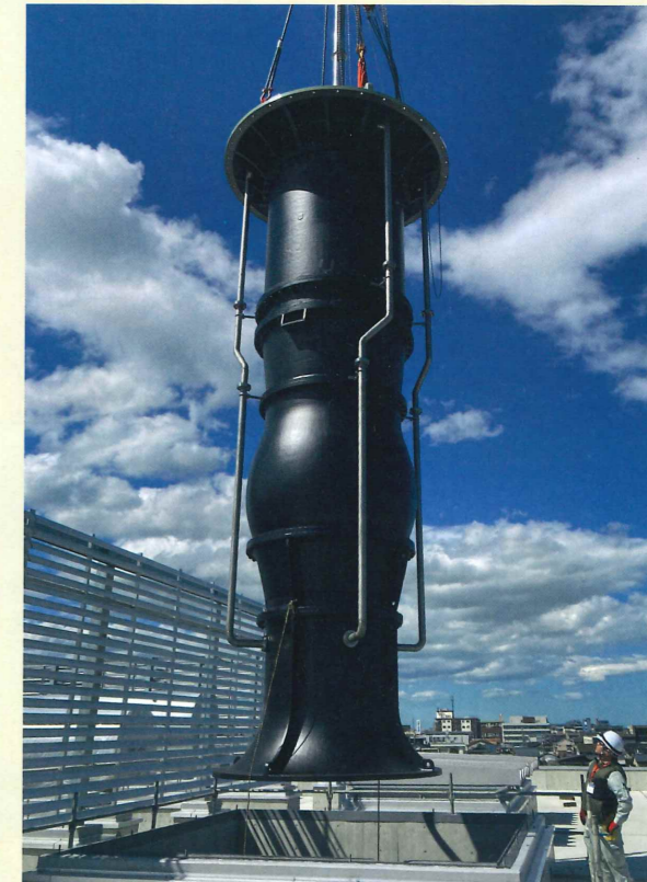
設置の際に吊り上げた雨水ポンプ
