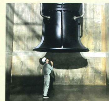
地下に設置された雨水ポンプ
