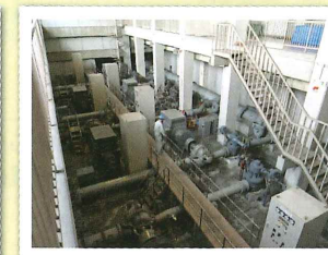
配水ポンプ 市内各地に水道水を送っています。
